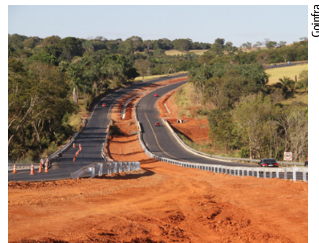
Obras de duplicação da GO-010, entre Goiânia e Senador Canedo, alcançam 70% de execução
